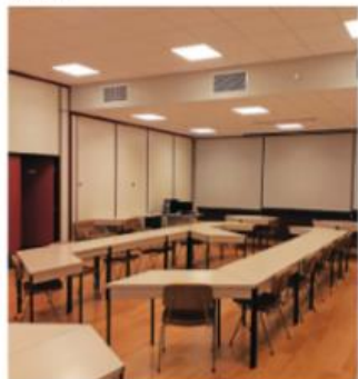
Figura 3 – Controlo de isolamento térmico e acústico do teto falso e de iluminação elétrica e climatização.
