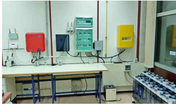
Fig. 6. Sistema de produção e armazenamento de energia
